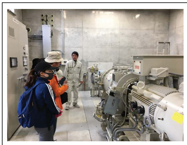
ダム内部：機械室の説明②
